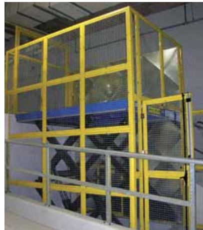
Lastentransport mit kundenseitiger Absicherung durch Schutzgitter und elektrisch verriegelter Türe
